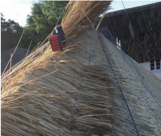
Foto 32 Rygning med overbuk
