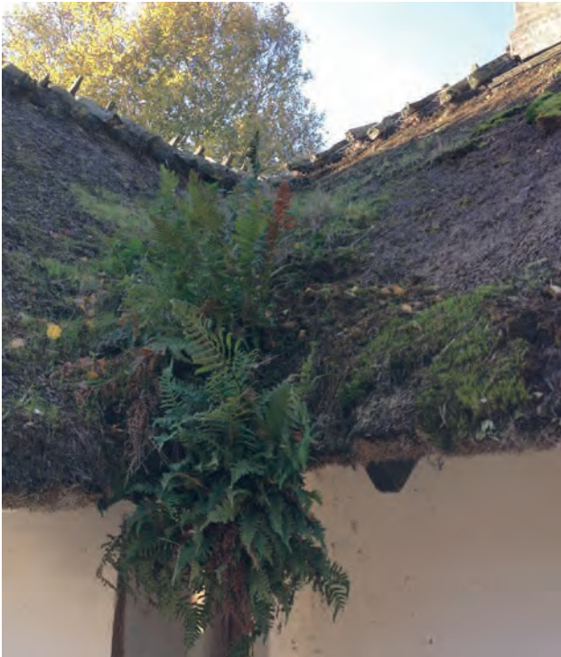
Foto 63 Manglende vedligehold af taget
