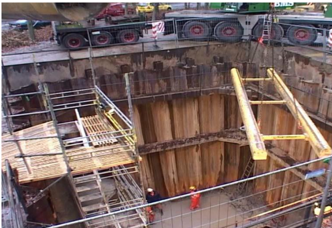
Afskærmet byggegrube. Bemærk stillads med trapper og reposer for sikring af forsvarlige nedstigningsbetingelser.
