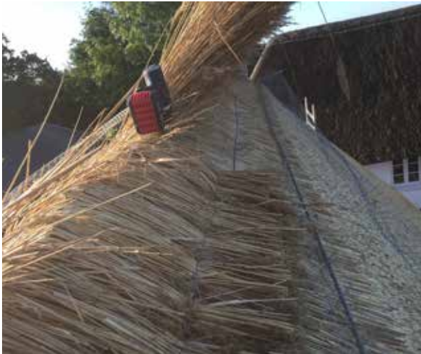
Foto 32 Rygning med overbuk
