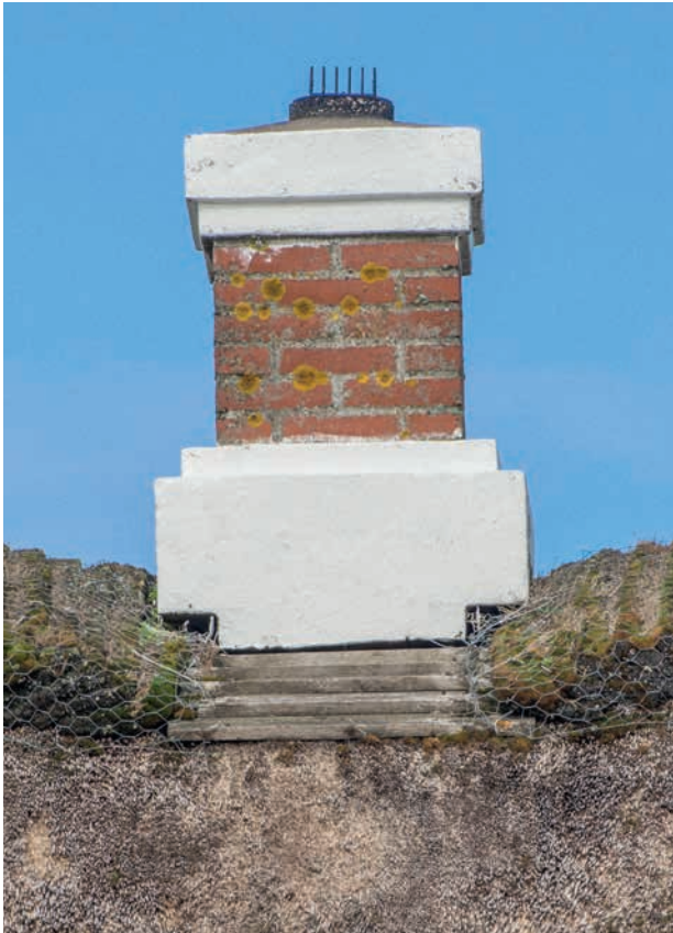
Foto 56 Skorsten med muret udkrøgning
