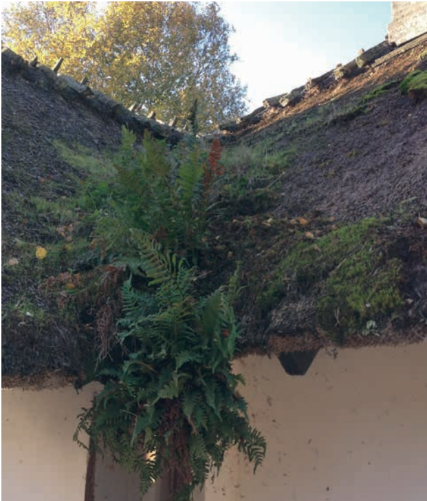
Foto 63 Manglende vedligehold af taget
