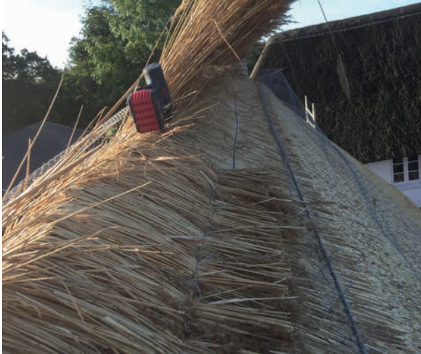
Foto 32 Rygning med overbuk
