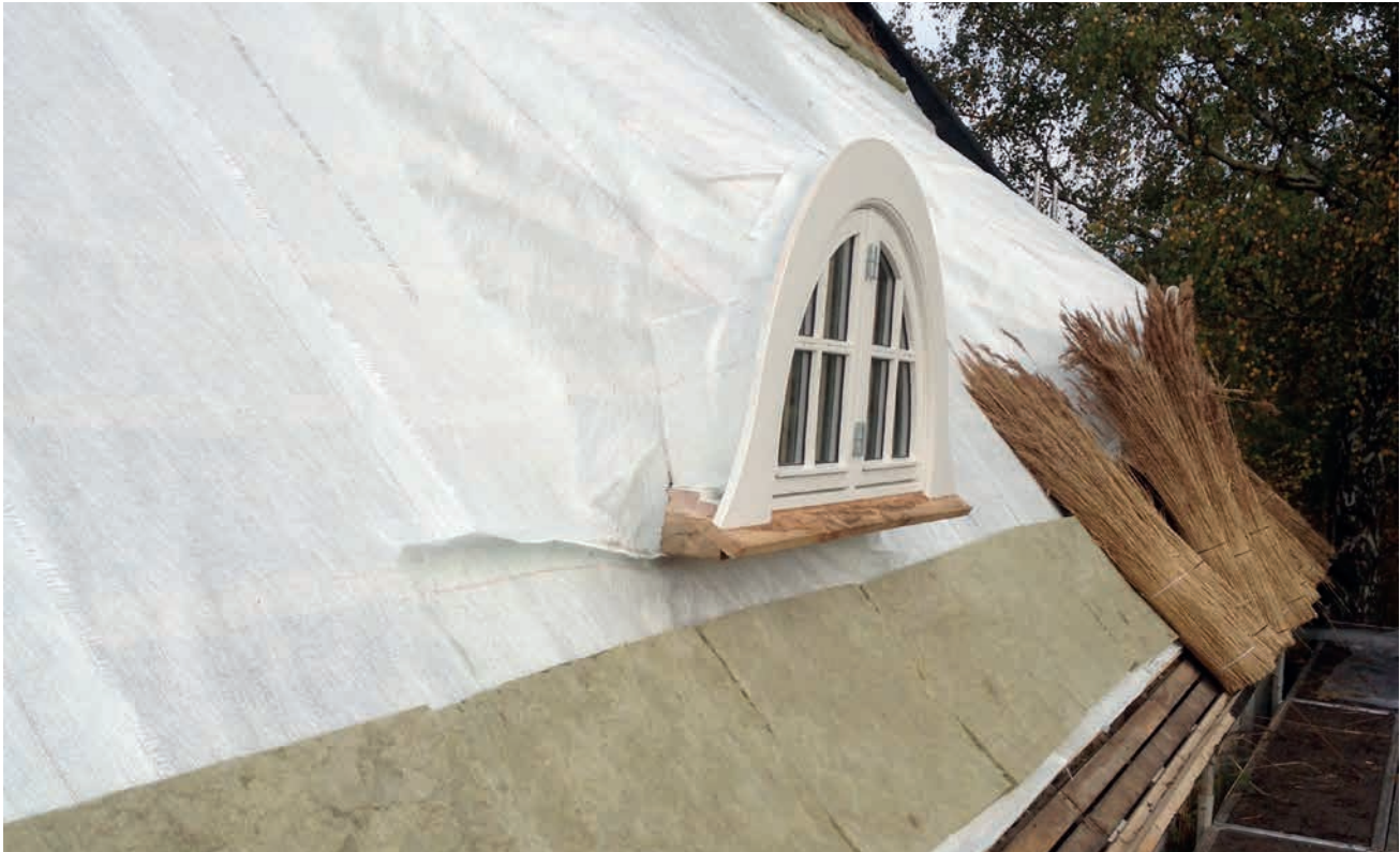
Foto 6 Brandsikring med godkendt glasfiberbug og kantisolering
