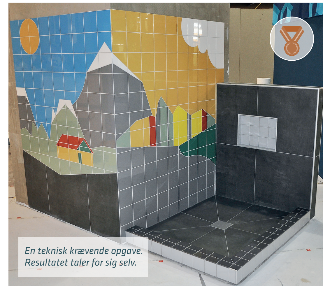
Som enhver flisemurer ved: Forarbejdet er nøglen til et vellykket stykke flisearbejde.
